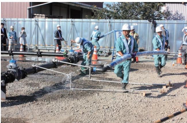
複数箇所破損のため、仮設配管を用意
