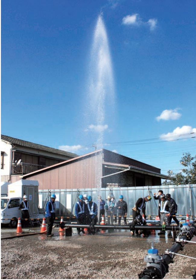
漏水箇所から水が吹き上がる
