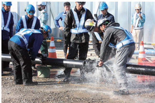
サドル分水栓が破損と想定
