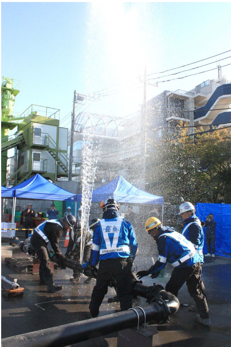
漏水箇所から水が吹き上がる
